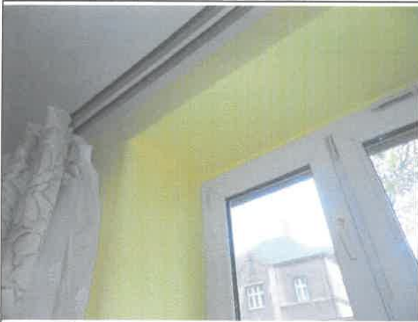
Fot. 11. Śladowe ogniska korozji biologicznej w postaci pleśni (Aspergillus - pokój nr 2).
