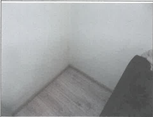
Fot. 03. Widoczne nie wielkie zawilgocenie ścian w narożniku budynku (pokój nr 1).
