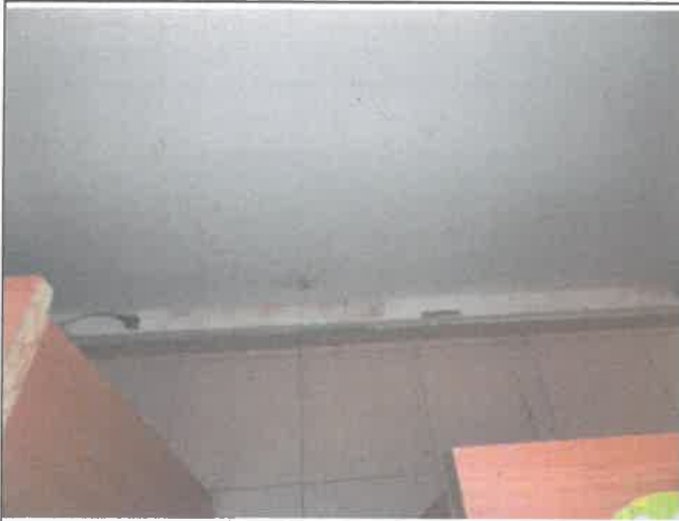
Fot. 05. Kuchnia nie wielkie ogniska korozji biologicznej (Aspergillus).
