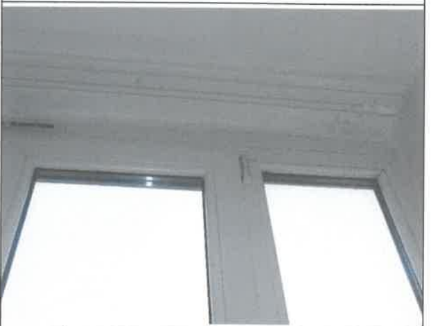
Fot.10. Śladowe ogniska korozji biologicznej w postaci pleśni (Aspergillus - pokój nr 3).
