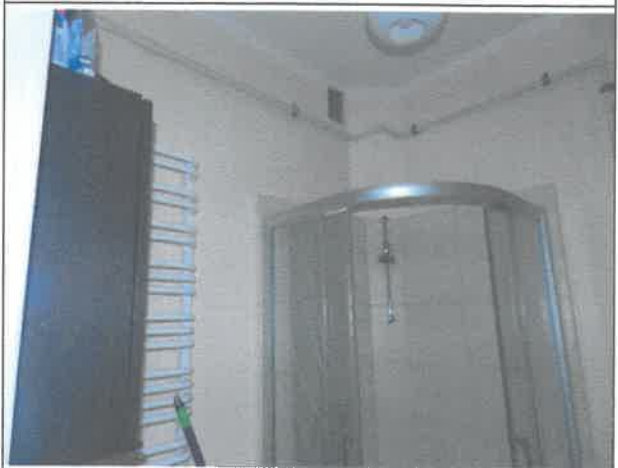
Fot. 16. Widok wentylacji w pomieszczeniu łazienki.
