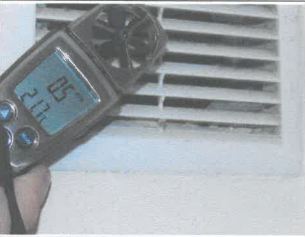
Fot. 15. Pomiar przepływu powietrza przy kratce wentylacyjnej (łazienka).
